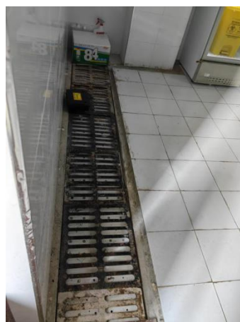
危废暂存间内收集沟
