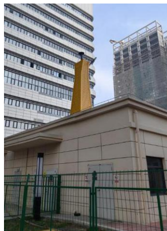
除臭设施排气筒（DA001）
