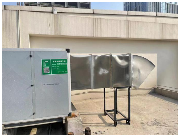
油烟排气筒（DA002）
