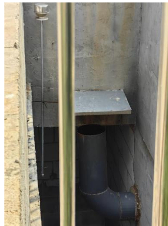
柴油发电机尾气排放口
