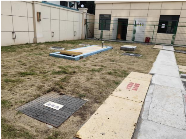
地理式污水处理设施
