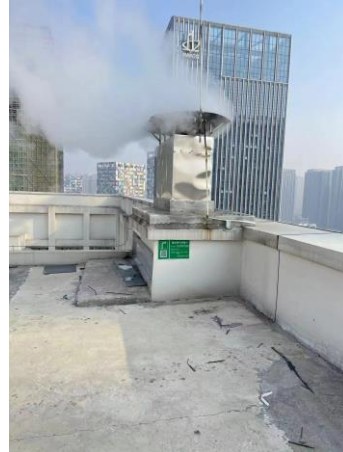
锅炉排气筒（DA003）
