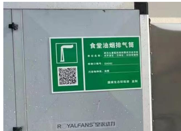
排气筒 DA002 标识牌
