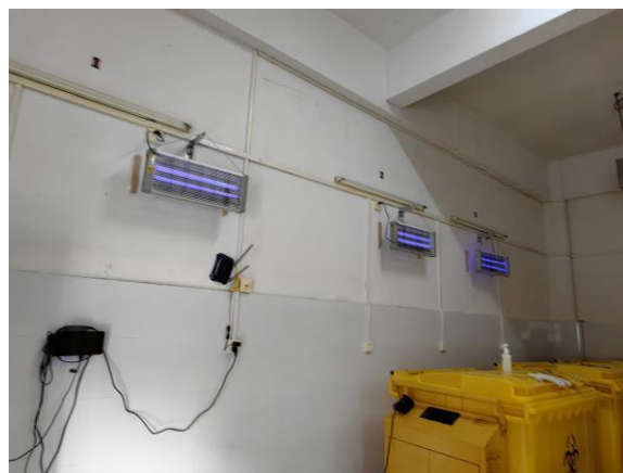
危废暂存间紫外消毒灯
