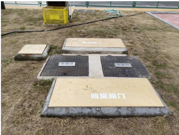
地理式污水处理设施
