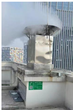
排气筒 DA003 标识牌
