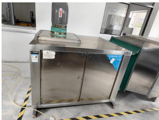
除臭设施活性炭吸附箱
