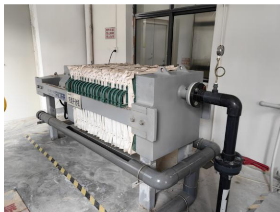
污水处理站污泥脱水设施
